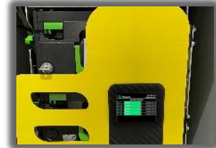
System im automatischen Pairing-Modus – An der Smartdoor und den Kassetten werden keine Netzwerk-Sticker verwendet.
